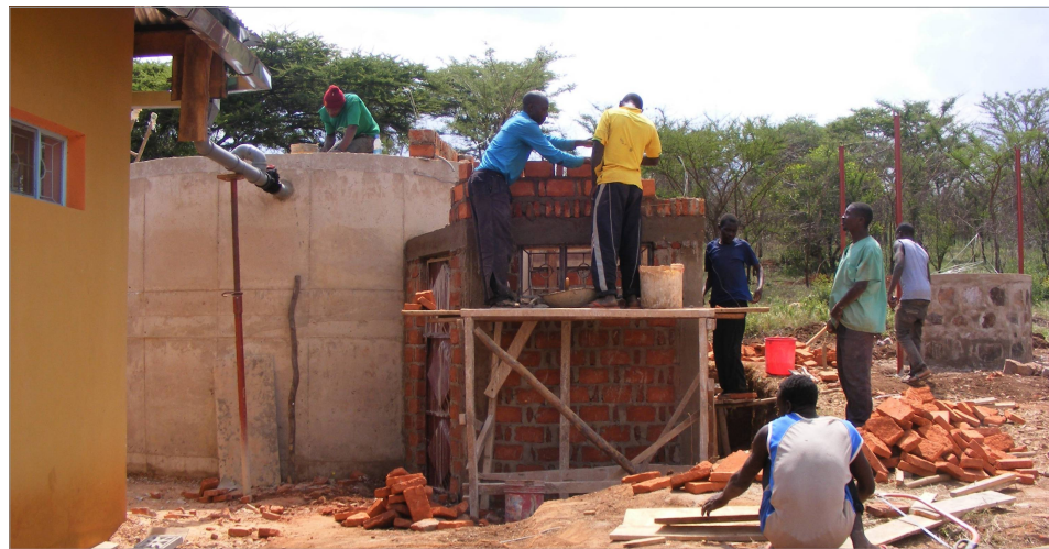
Die Wasseraufbereitungsanlage – zu erkennen ist auch die Anbindung der Dachrinne – wuchs im Vorjahr in die Höhe. Nun fehlen aber noch vier Klassenräume.
