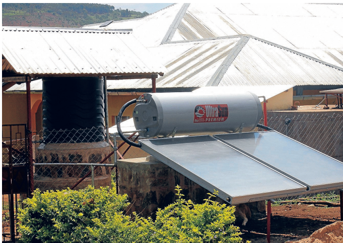
Neben einer Solaranlage konnte auch eine Wasseraufbereitungsanlage am Schulgebäude installiert werden. Fotos: pr.
